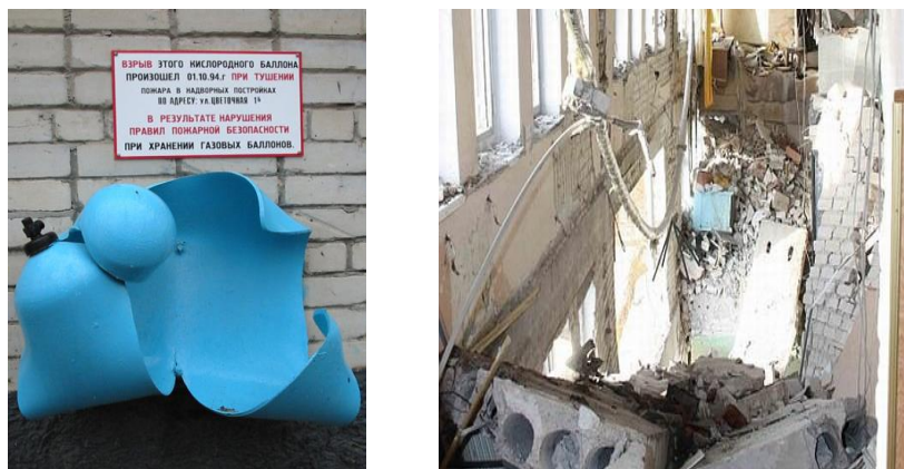
Рис. 4 -5. Повреждение баллона и последствия взрыва баллона с кислородом
